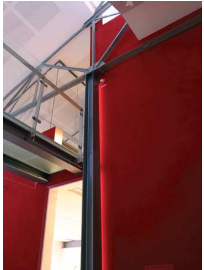
Röda LINEARlight® FLEX kunde diskret gömmas på baksidan av befintliga vertikalkalkar, för att ge ett formförstärkande reflektionsljus mot röda väggar. För elektronisk ljusstyrning användes don av OPTOTRONIC®-typ.
