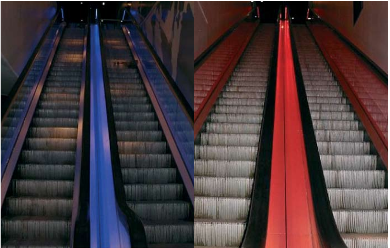
I fyra rulltrappor monterades totalt 150 m färgkombinerade LED-moduler i RGB (rött, grönt, blått). Dessa växlar färg genom styrning över trekanals ljusregleringsdon som kommunicerar med en DMX-enhet.
